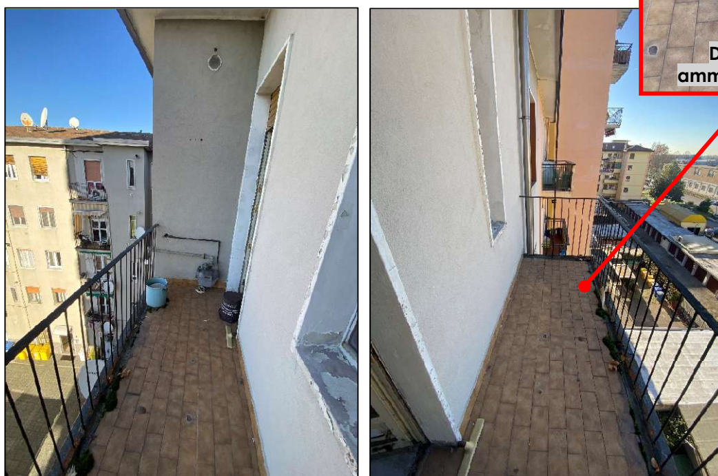
Foto n°15-16 – Balcone con un dettaglio delle parti ammalorate
