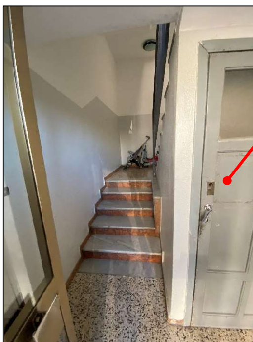
Foto n°7 – Androne della scala "E" di limitate dimensioni (si notano le barriere architettoniche)
