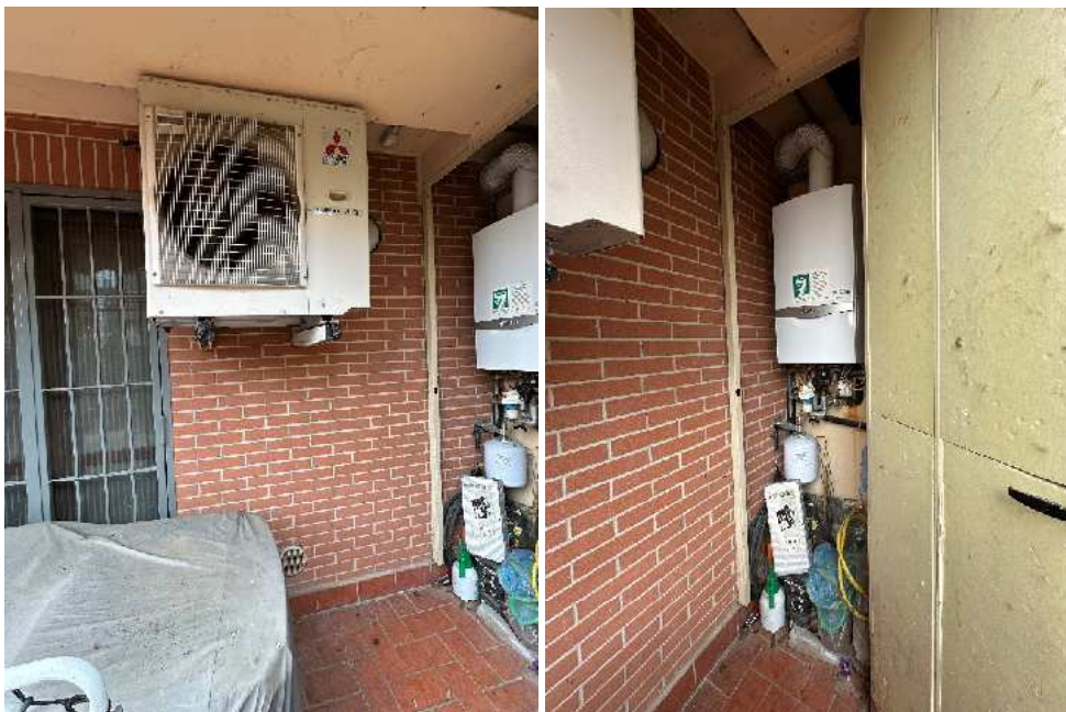
11. Vista degli impianti (condizionamento e caldaia) le cui unità esterne si trovano nella parte di pertinenza del subalterno pignorato.
